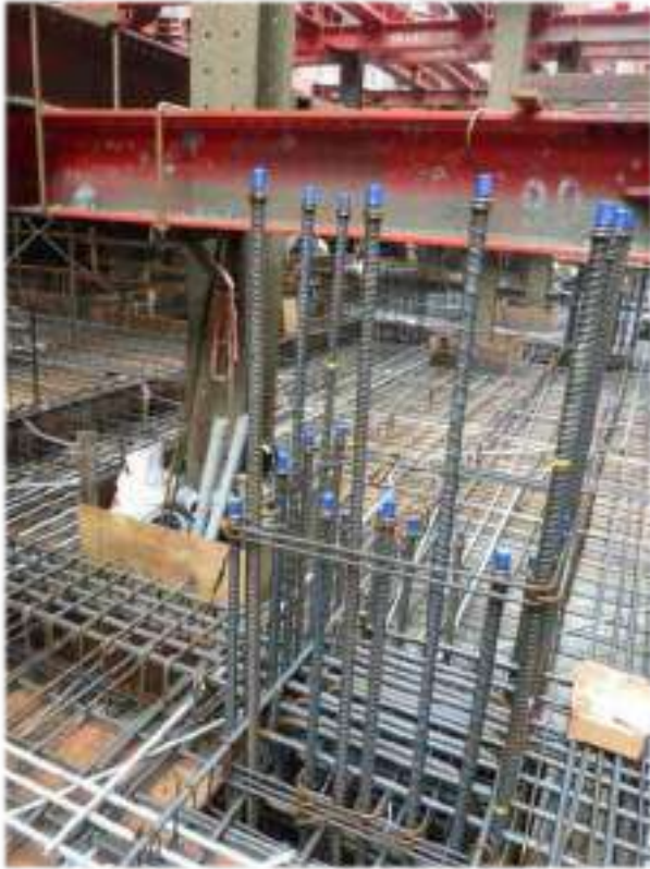
勞工墜落之安全支撐型鋼
