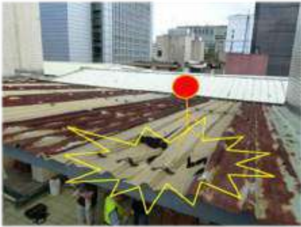
罹災勞工踏穿塑膠浪板後墜落至地面
