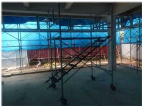
現場不合格移動式施工架
