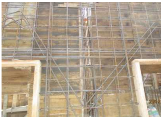
補強鋼筋未依圖說綁紮(二)
