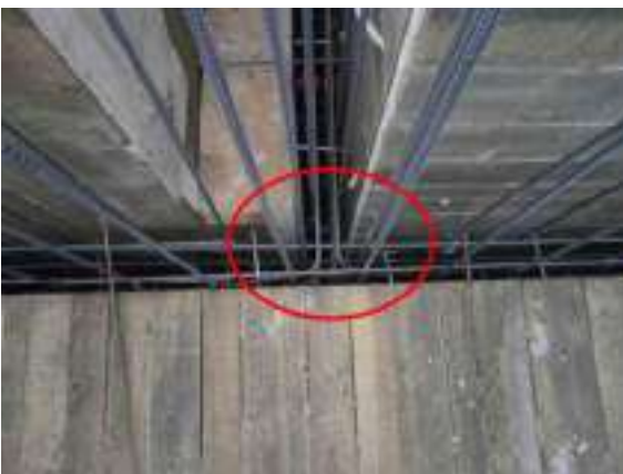
遺漏 T 型轉角補強鋼筋
