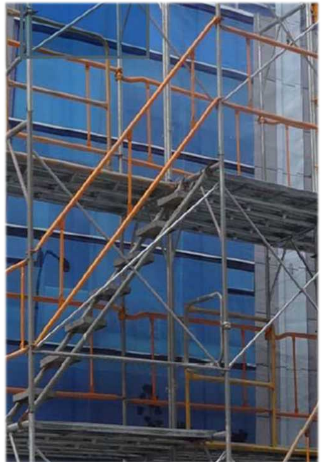
施工架應設置安全上下設備。
