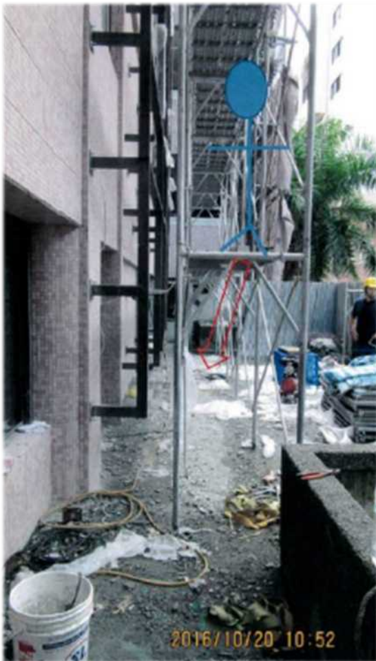
該施工架未設置安全上下設備，造成 勞工文○○爬下施工架時墜落至露臺 地面（墜落高度約1.75 公尺）
