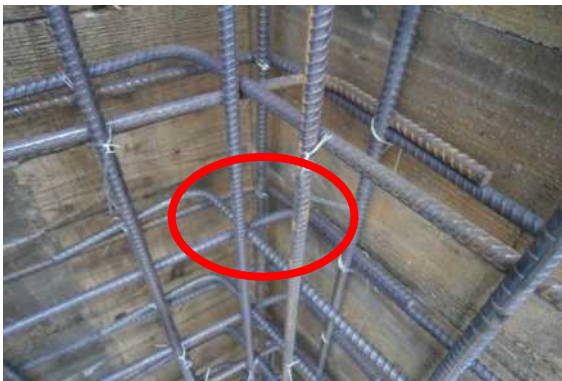
遺漏 L 型轉角補強鋼筋
