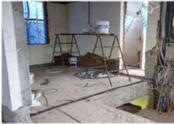
勞工作業區域位於樓梯開口旁
