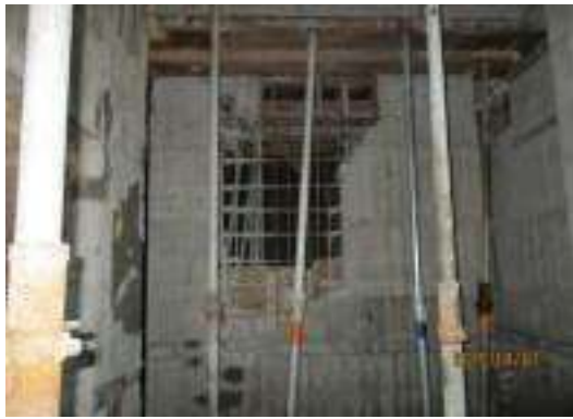
混凝土粗粒料受斜向補強筋阻隔無法填滿牆體(二)
