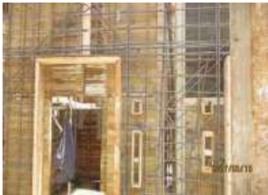
補強鋼筋未依圖說綁紮(一)
